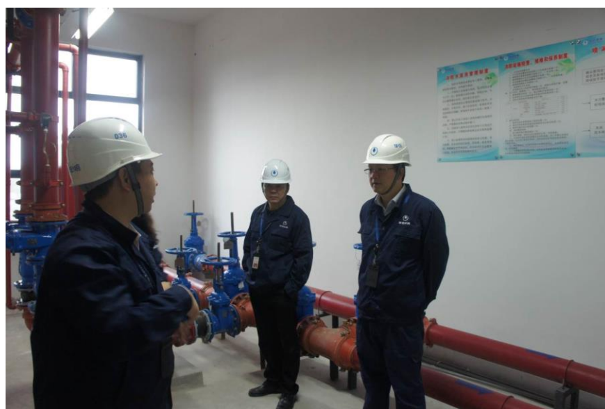
汤阳总经理检查办公楼消防泵房
