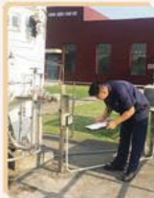
▲ 高峰供水期间检查泵机设备
