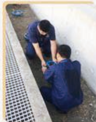
▲ 高峰供水期间开启沉淀池排泥闸门排泥
