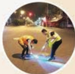
▲ 检漏人员在盛泽南环路用听漏棒检测到水流声音，用管子打开井盖观察
